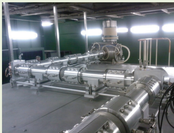
СВЧ-тракт (170 ГГц / 1,5 МВт) с волноводным уголком и направленными ответвителями
